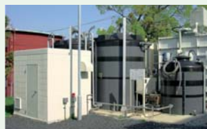
■ 株式会社島津製作所 10m 3 /日厨房&洗浄油排水処理設備 備鉍油の混じる洗浄水も同時処理 島津製作所 社内環境賞を受賞!!
